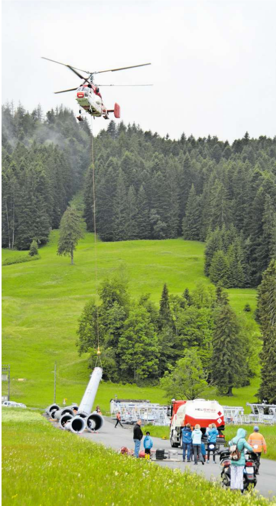
Der erste von insgesamt acht Masten ist befestigt und wird durch den Schwerlastenhelikopter an seinen Bestimmungsort geflogen.
