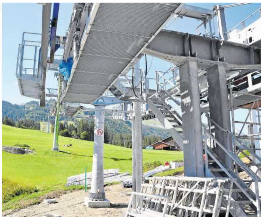
Bei der Talstation der Sesselbahn im Wildhauser Oberdorf ist bereits ein grosser Teil der Seilbahn-technik montiert.
