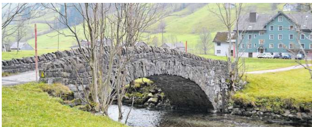
Muss instand gehalten werden: eine der Rundbogenbrücken, auch Römerbrücken genannt, führt von Sonnenhalb über die Thur zum Altersheim Horb. Bild: Adi Lippuner
