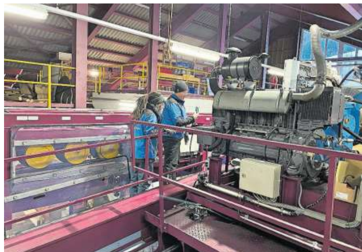
Vor dem Beginn des Bahnbetriebs nehmen die Mitarbeitenden verschiedene Sicherheitsprüfungen vor.
